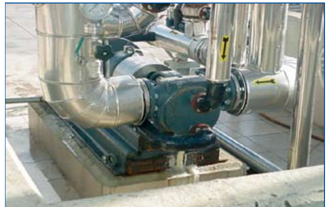
安装于清洁剂生产车间的泵 Pompa installata in un impianto per produzione di detersivi Pump installed in a detergent production plant
